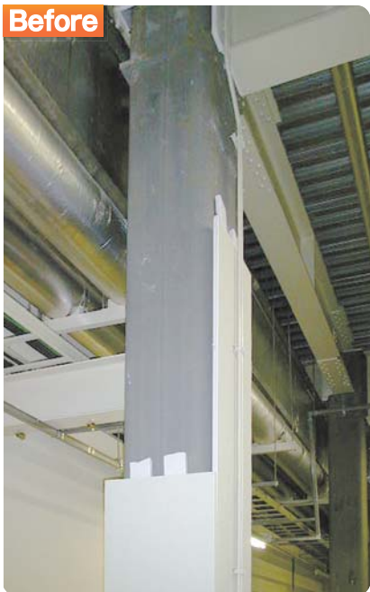
けい酸カルシウム板の破損
