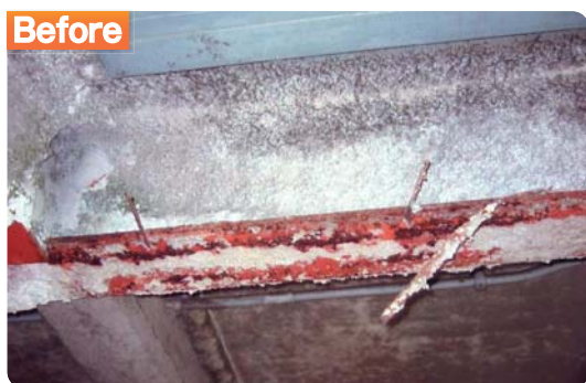
ロックウールの脱落
