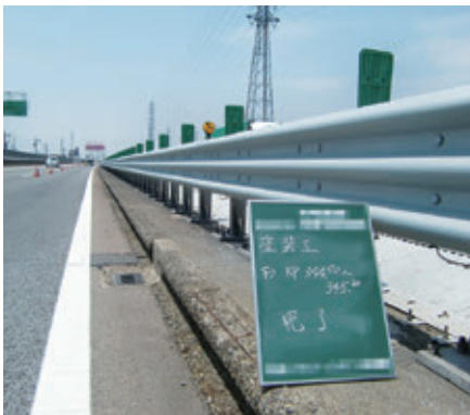
◆ガードレール
