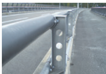
ガードレール
