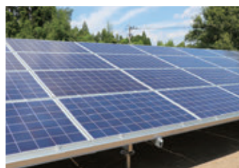
太陽光発電電架台
