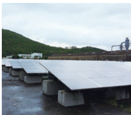
◆太陽光発電設備
