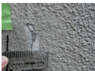
基材からのひび割れ
