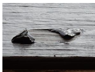
塗膜の剥がれ
