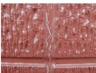
目地部のひび割れ
