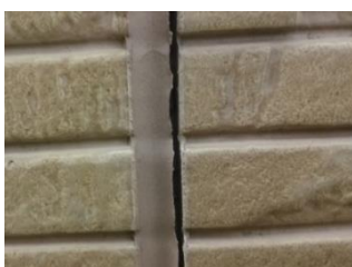
シーリングの破断
