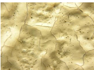
塗膜のひび割れ
